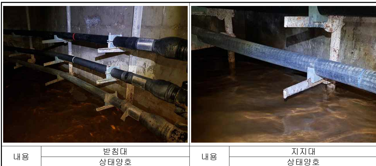
【사진 11.48】 부속 및 부대설비 현황
