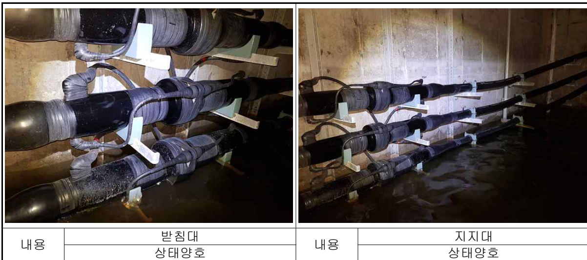
【사진 11.44】 부속 및 부대설비 현황
