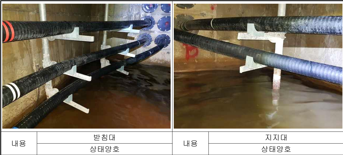
【사진 11.64】 부속 및 부대설비 현황
