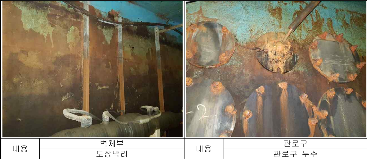
【사진 11.14】 맨홀 내부 주요 손상
