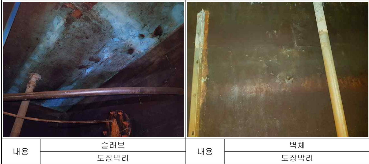
【사진 11.6】 맨홀 내부 주요 손상
